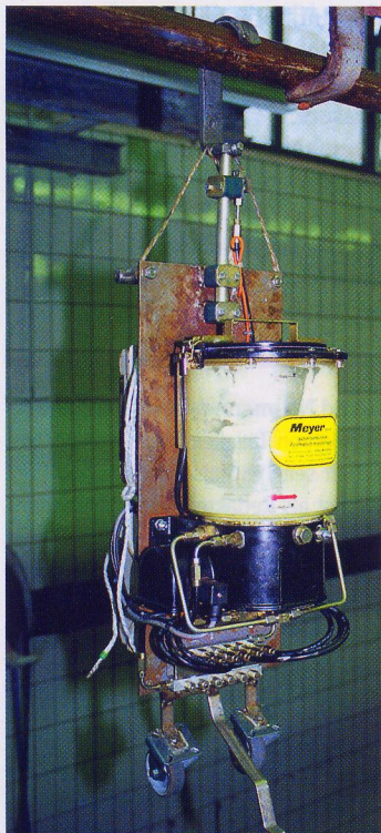
Das neue automatisierte Rohrbahnschmiersystem
