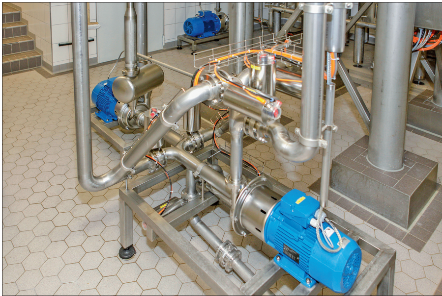
Drei der insgesamt zehn installierten Packo-Kreiselpumpen: rechts eine Pumpe zur Maische-Förderung, links die CIP-Return-Pumpe. Im Hintergrund ist die CIP-Vorlaufpumpe zu sehen. (Foto: K. Wittlieb)
