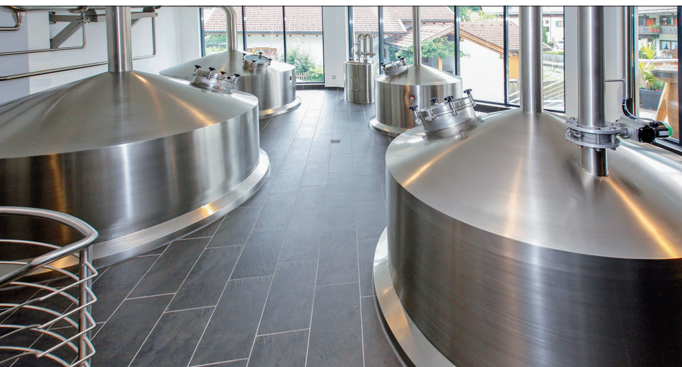
Blick in das neue Sudhaus: rechts vorne der Maischbottich, dahinter die Maischpfanne zu sehen. Links vorne steht der Läuterbottich und hinten die Würzpfanne mit Whirlpool. (Foto: K. Wittlieb)
