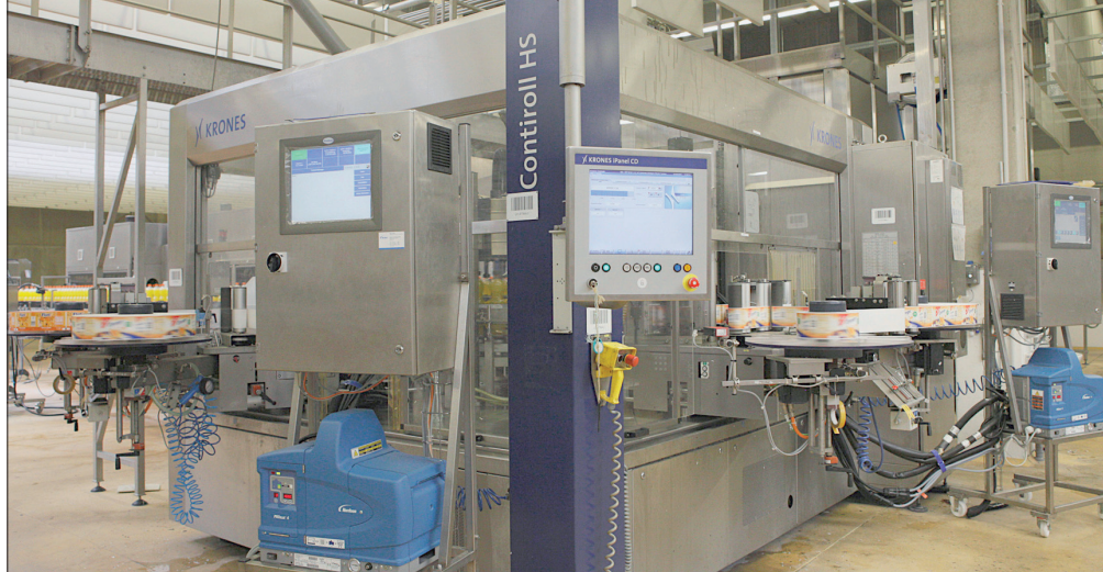
Hochleistungs-Etikettiermaschine Controll HS mit zwei Etikettenrollenzuführungen und zwei Hotmelt-Befüllsystemen
