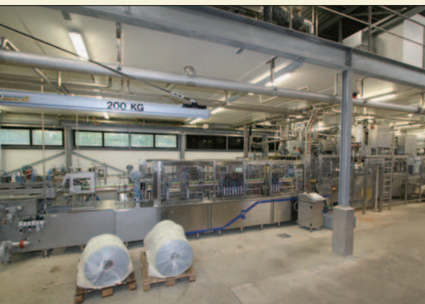
In der Gesamtansicht wird die Größe der Beutelform-, -Füll- und -Verschleißlinie deutlich.
