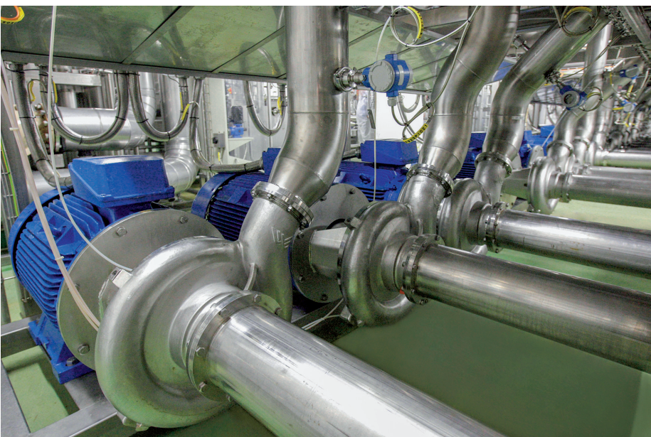
In der ersten Umrüstungs-Phase wurden insgesamt 16 Packo-Kreiselpumpen des Typs MFP 3 mit einer Leistung von jeweils 90 kW verbaut.
