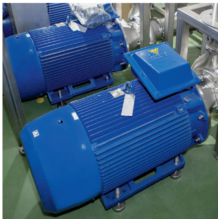
Derzeit in der Installation sind noch leistungsstärkere MFP3-Pumpen mit 200-kW-Motoren.
