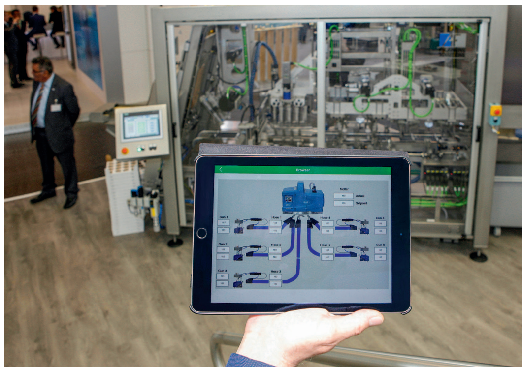
Das Hotmelt-Auftragssystem ist auch von außerhalb der Verpackungsmaschine via Tablet-PC online kontrollier- und regelbar
