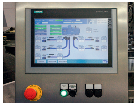
Die Steuerung des Schmelzgeräts ist in das HMI der Hauptmaschine eingebunden
