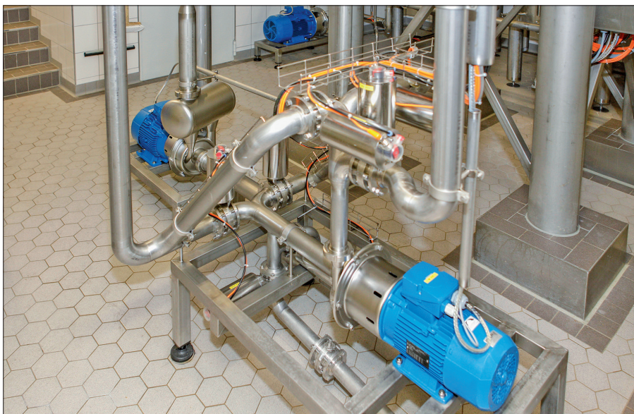
Drei der insgesamt zehn installierten Packo-Kreispumpen: rechts eine Pumpe zur Maische-Förderung, links die CIP-Return-Pumpe. Im Hintergrund ist die CIP-Vorlaufpumpe zu sehen. (Foto: K. Wittlieb)
