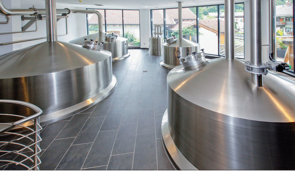
Blick in das neue Sudhaus: rechts vorne der Maischbottich, dahinter die Maischpfanne zu sehen. Links vorne steht der Läuterbottich und hinten die Würzpfanne mit Whirlpool. (Foto: K. Wittlieb)
