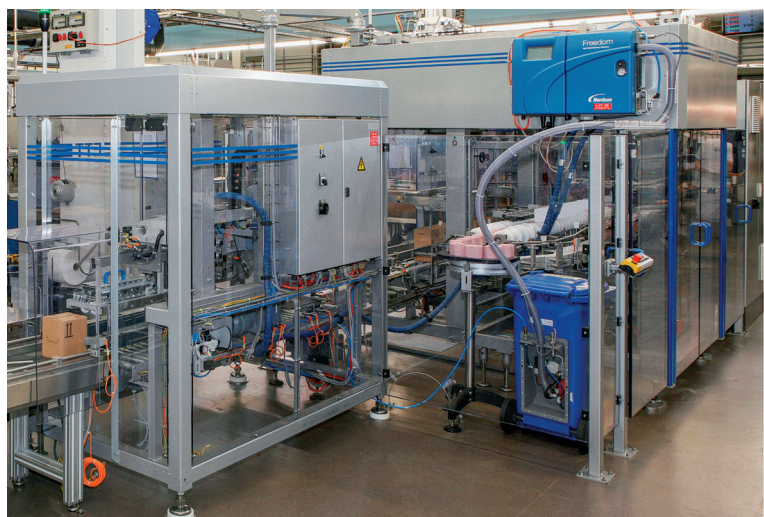
Eines der beiden neuinstallierten tanklosen Schmelzklebstoff-Auftragsysteme Freedom versorgt im Mibelle-Werk in Buchs – oben an der Endverpackungsanlage montiert – gleichzeitig einen Kartonaufrichter und den Verschliesser mit Hotmelt.
